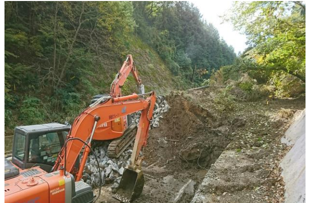
戸沢峠の崩落現場
