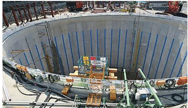
名古屋市名城非常口で出水事故、工事中断
