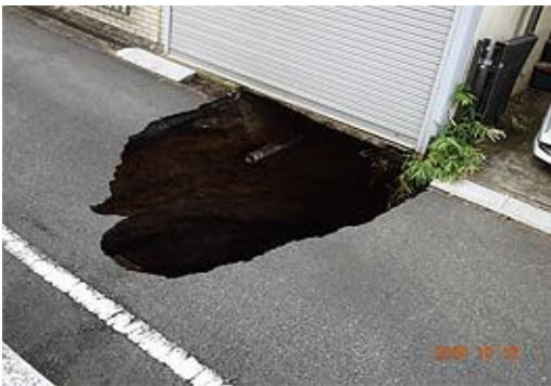
東京外環道トンネル工事による陥没(調布市) 写真:池田あすえ氏
