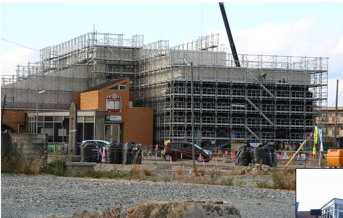
建設中の双葉駅。まだ周辺にはフレコンパックが見られる。(2019.11.16)
