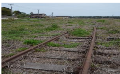
錆びた常磐線の線路
