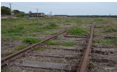
錆びた常磐線の線路
